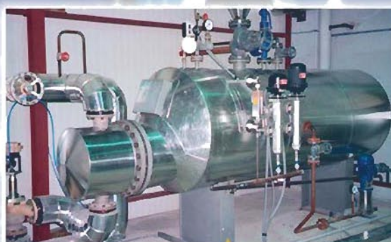
GENERADOR INDIRECTO VAPOR MEDIANTE ACEITE TÉRMICO
